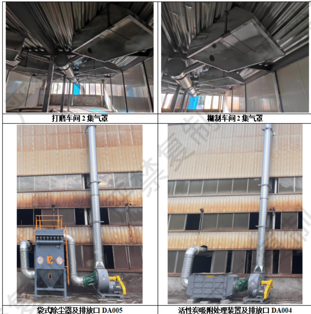
图4.1-2 废气治理设施照片
